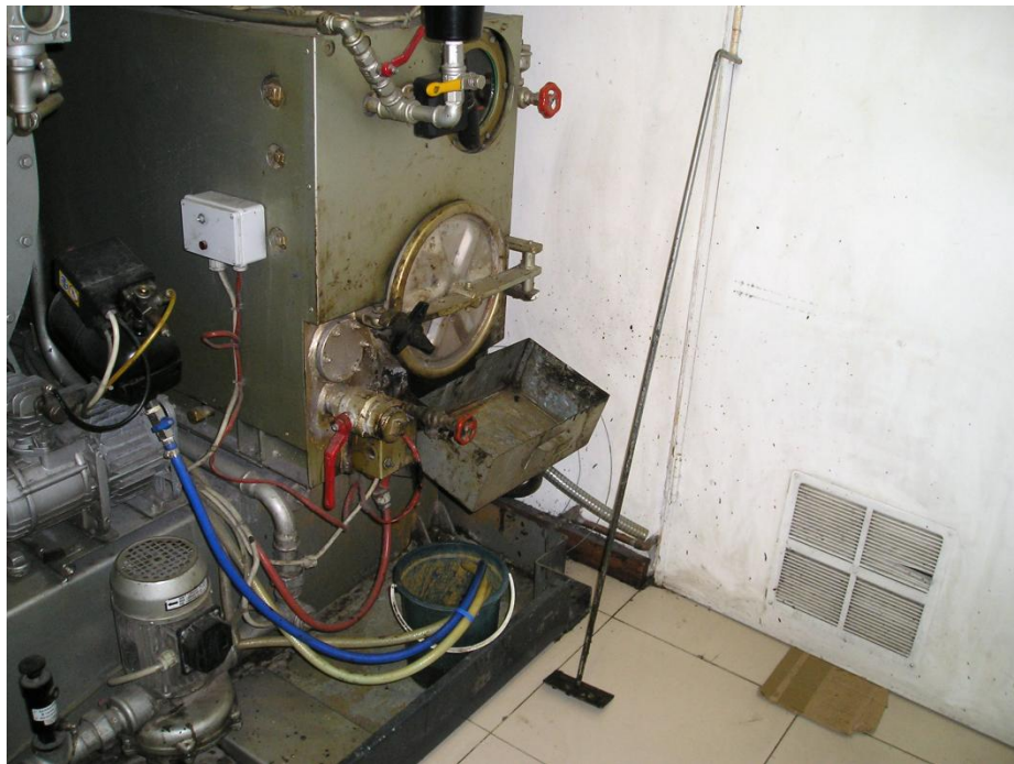
Fig. N°6.- Zona Caldera Máquina Firbimatic 915L
